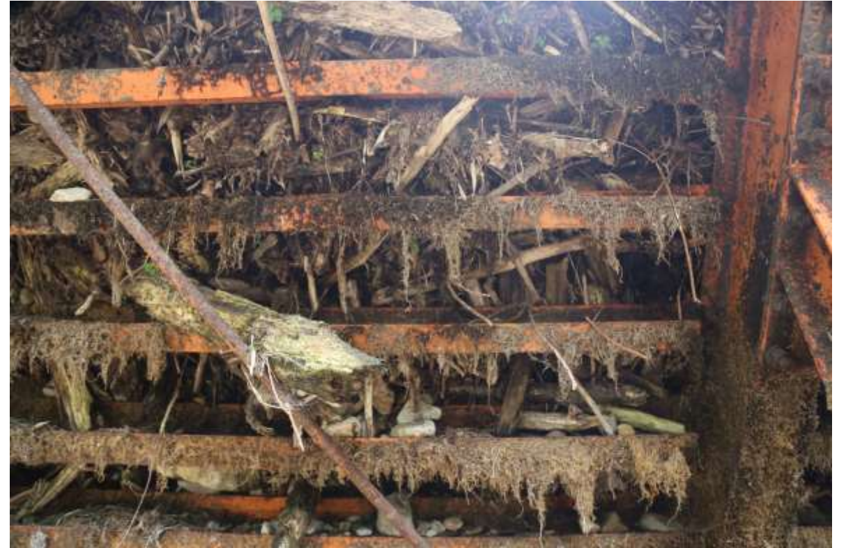
鋼製ダムへの土砂堆砂状
